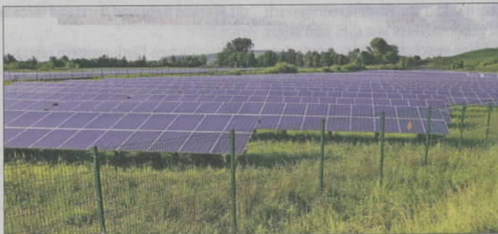
Rund 31.104 Module sorgen für sauberen Strom.
